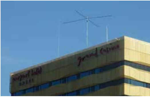
Hotel Antennenfarm. In der Mitte der Spider-Beam, links die 40m Groundplane und rechts der 80m Dipol
